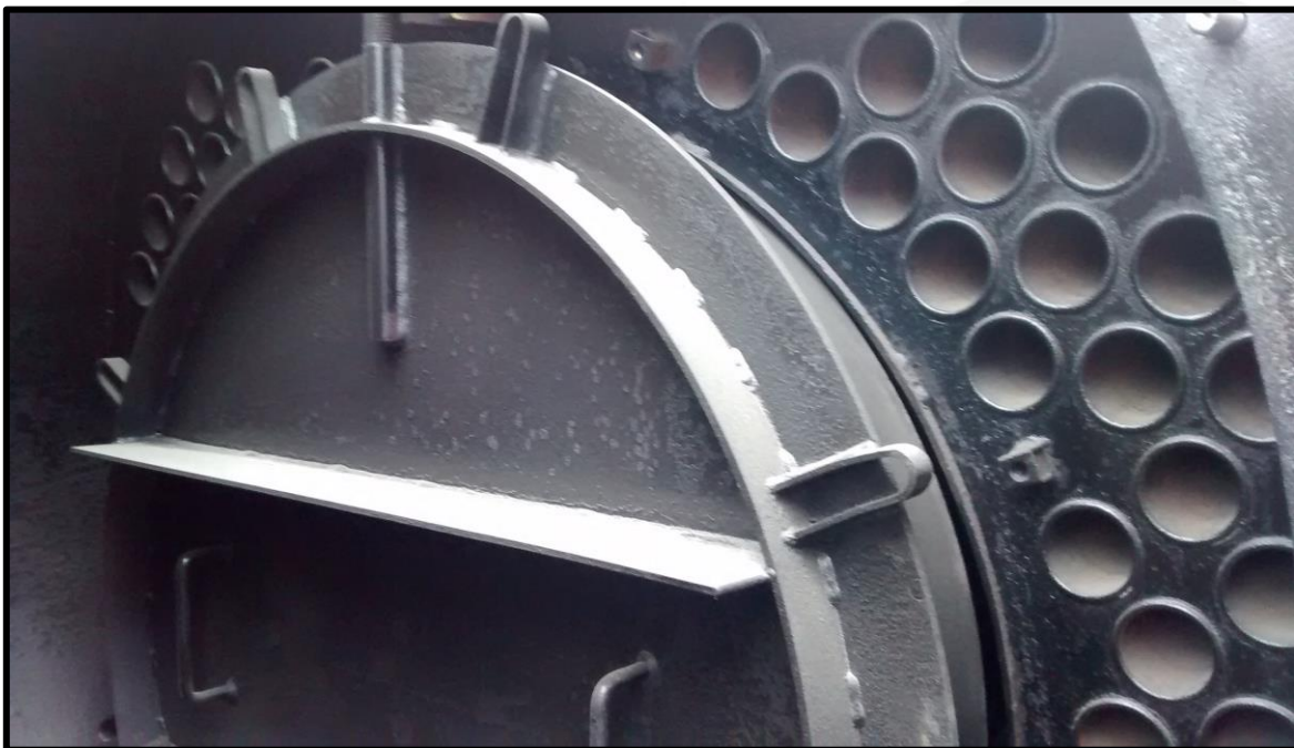
PROYECTOS DE GENERACIÓN DE VAPOR Y CALENTAMIENTO
